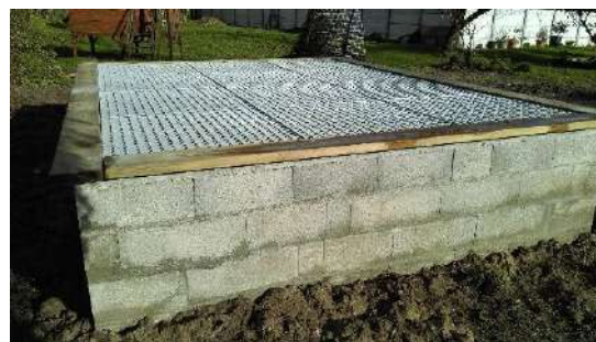
Pompe + Phytoépuration 5EH
